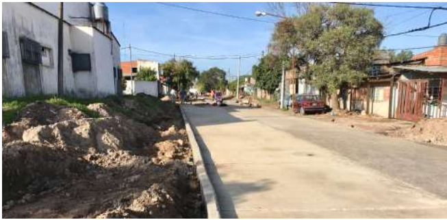
Pavimento barrio Zapata.
